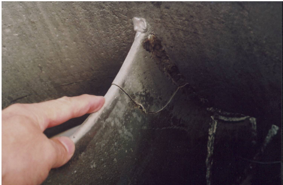
Slika 3. Detalj pukotine na kućištu aeratora
