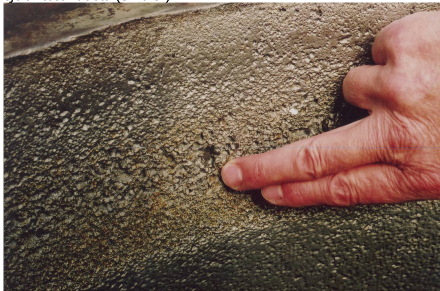
Slika 5. Trošenja na unutrašnjosti cilindra aeratora
